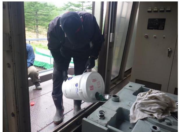
減速機オイル交換の様子
